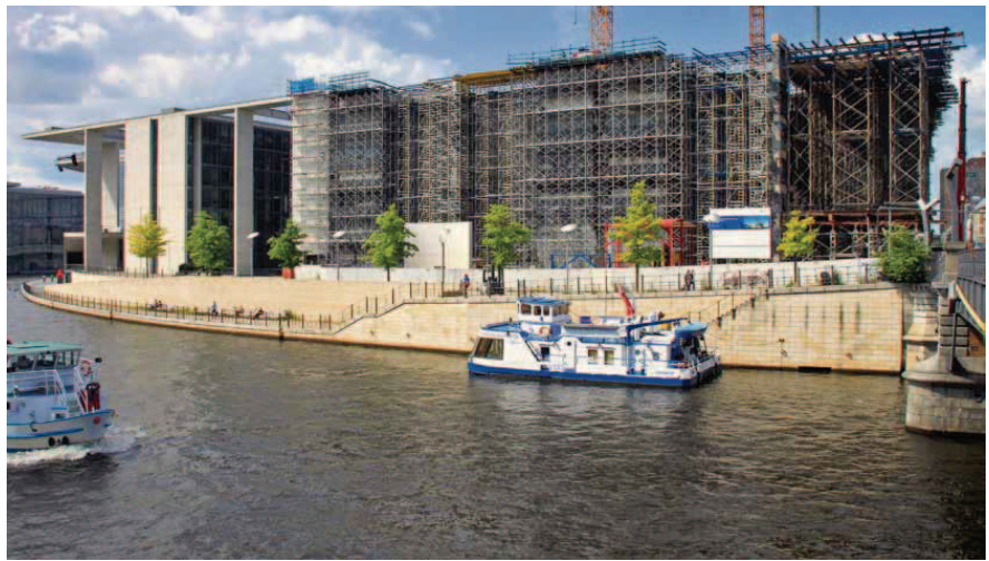
Eine besondere Herausforderung stellen die Sichtbetonbalken und -deckenstreifen für die ausragenden und bauteilverbindenden Decken in rund 22,00 m Höhe dar.
