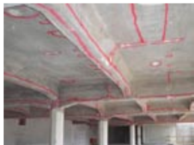
Markierte Bereiche der abzutragenden Betonflächen (Hohlstellen des Betons) an den abgestrahlten Deckenuntersichten
