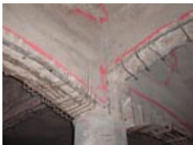
Abgetragene Betonflächen an den Untersichten der Unterzüge
