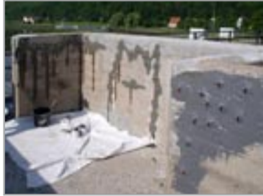
Risseverpressung in Stahlbetonbrüstung auf Kraftwerkspfeiler
